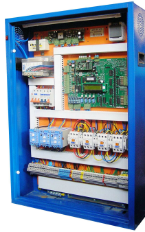
تابلو فرمان EC16
